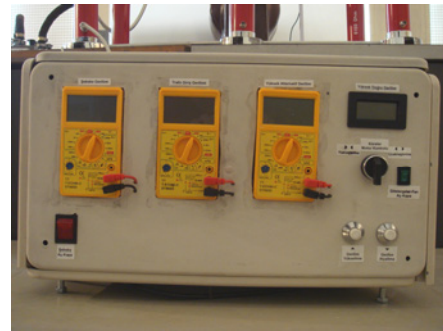
Şekil 9: Yapılan kontrol ve kumanda panosu.
