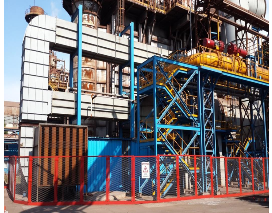
Harici Yanma Tesisi
