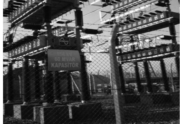
Resim 4 Kızıltepe 2 TM 154 KV 60 MVAR Kapasitör (Montajı tamamlandı)
