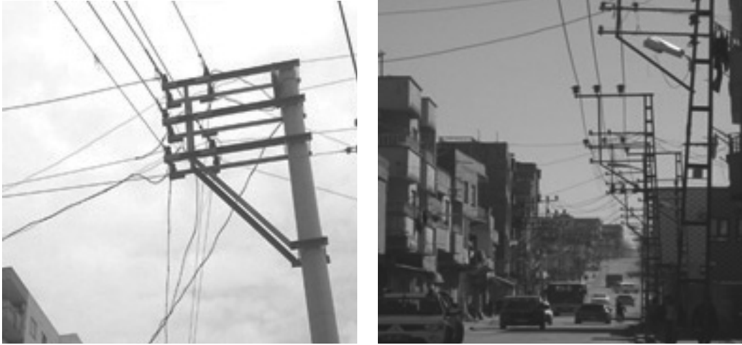
Resimler: Bölgede Elektrik Dağıtım Şebekesinden Görüntüler
