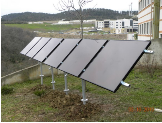
Şekil 4. FV modüllerin fotoğrafı.
