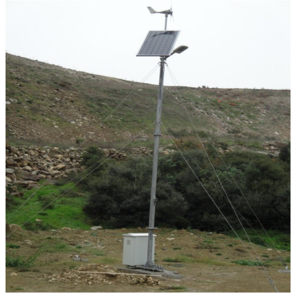
Şekil 5. Fotovoltaik enerji depolama sistemi fotoğrafı.
