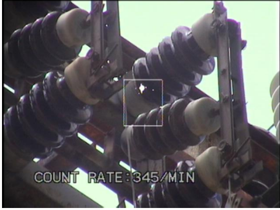
Şekil 7 Müşteri hattında korona oluşumu
