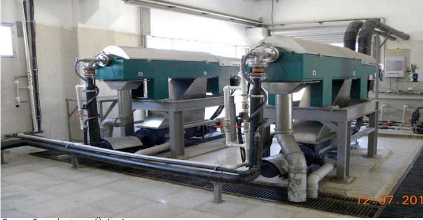
Çamur Susuzlaştırma Ünitesi
