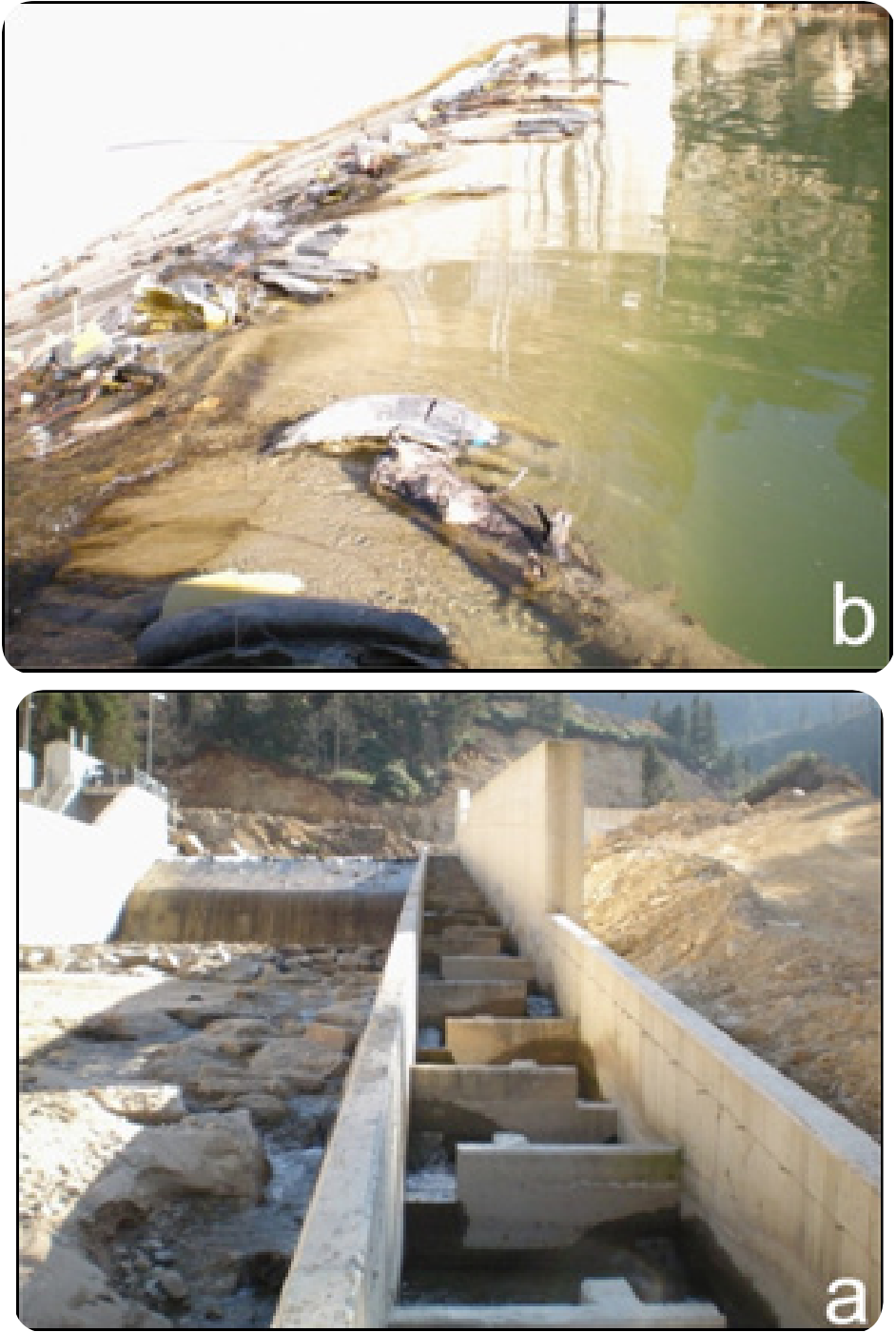
Şekil 12. (a) Uygunsuz Balık Merdiveni ve (b) Balık Ölümleri
