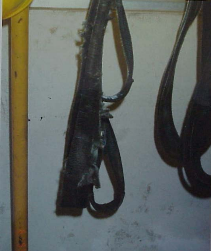
Hasar görmüş sapanlar şantiyeden kaldırılmalıdır.
