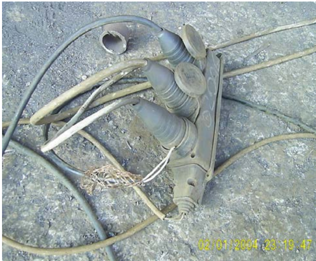
Kablo izolasyon ve eklerdeki hatalar
