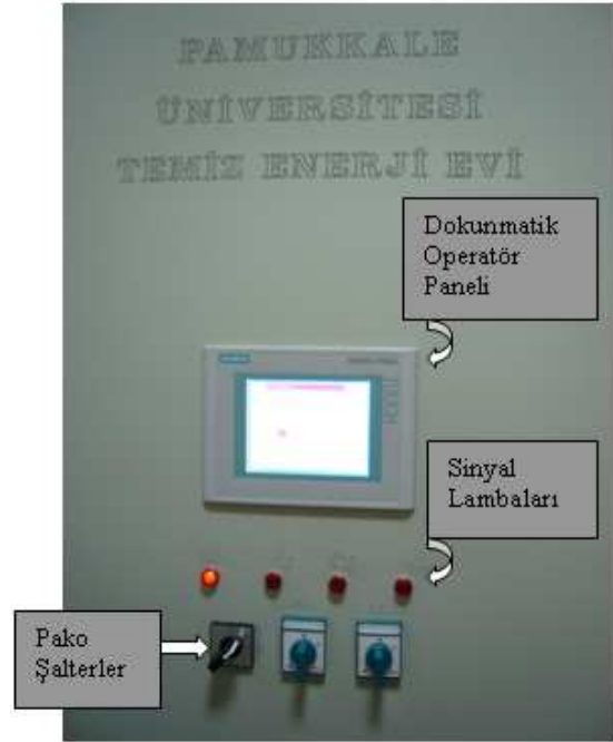
Şekil 19. Manuel kontrol ve izleme panosu
