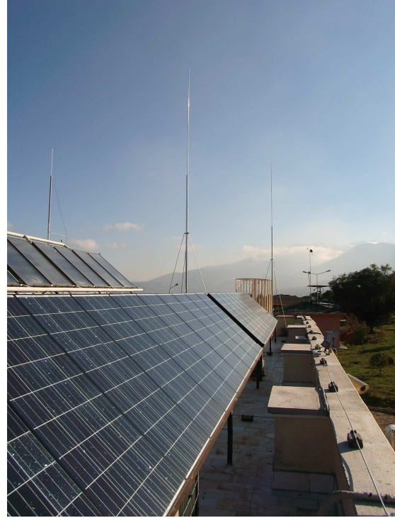
Şekil 2. Çatıda kurulu fotovoltaik paneller
