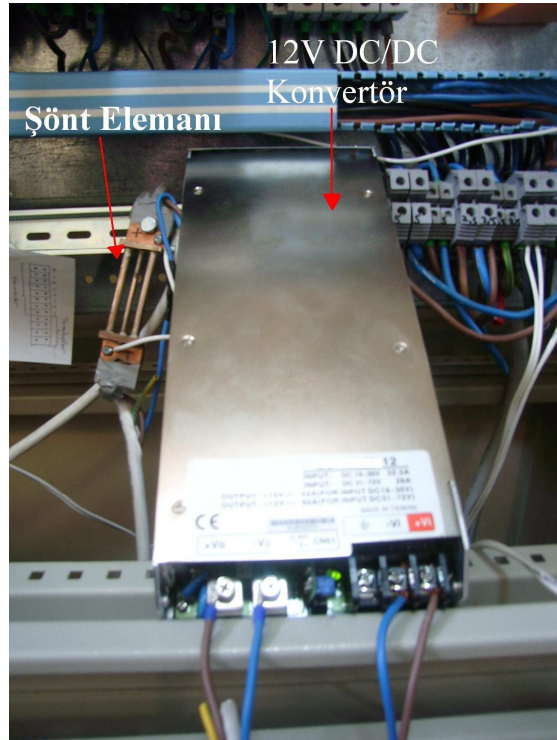
Şekil 11. Şönt elemanı ve 12V DC/DC konvertörün görünümü
