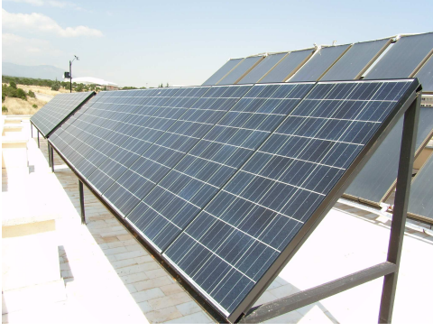
Şekil 3: Çatı montajlı fotovoltaik paneller.
