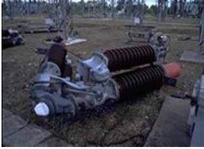
Şekil 5a ve 5b. Deprem yükü hesaplanmamış donanımlar [8]
