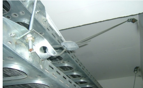
Şekil 35a, 35b, 35 c. Tesisatların onaylı sismik halatlarla deprem koruması
