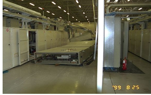
Şekil 3a ve 3b. Döşemeye ve/veya tavana bağlanmamış pano gruplarında, deprem sonrası meydana gelen hasar [8]
