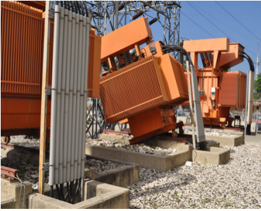
Şekil 2a ve 2b. Deprem koruması olmayan ekipmanlarda hasar oluşumu [8]
