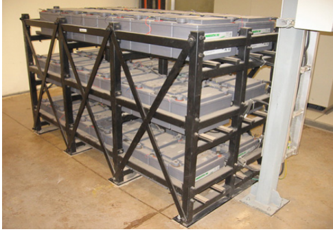
Şekil 32a, 32b. Akü ve raflarının deprem koruması
