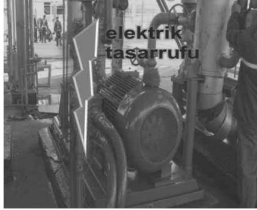
Şekil 4: Rafineri genelinde 31 adet pompa, fan ve kompresörlere VSD uygulama projesi ile elektrik tasarrufu
