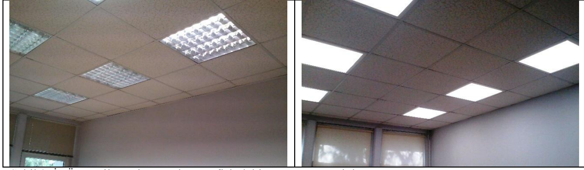
Şekil 2. İTÜ Enerji Enstitüsü çalışma ofisindeki mevcut ve yeni durum
