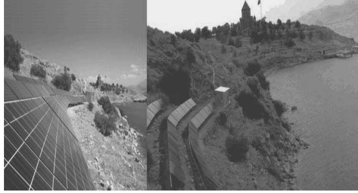
Şekil 7- Akdamar Adası güneş enerjisi uygulaması
