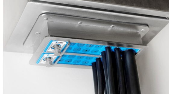
Şekil 8 Çoklu Kablo Geçiş Sistemleri Pano Uygulamaları
