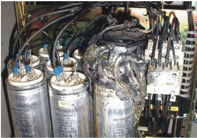
Fotoğraf 2: Harmonikler Nedeniyle Tahrip Olan Kondansatör
