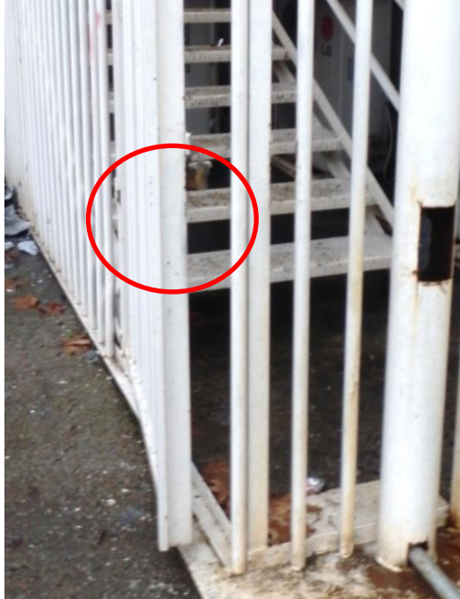
Şekil 4. Asma kilit ile kilitlenen acil çıkış kapısının fotoğrafı
