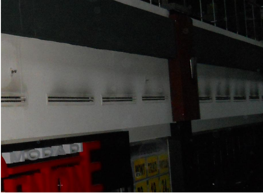
Şekil 2. Havalandırma tesisatında yangın damperleri bulunmadığını gösterir fotoğraf
