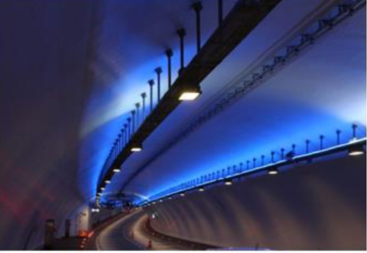
Şekil.1 Avrasya Tüneli Pacemaker aydınlatma uygulamasından görünüm
