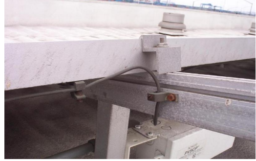
Şekil 5 :Güneş Panellerinde Malzeme Uyumsuzluğu
