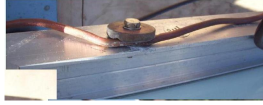
Şekil 5 :Güneş Panellerinde Malzeme Uyumsuzluğu
