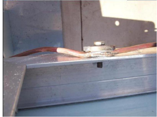
Şekil 5 :Güneş Panellerinde Malzeme Uyumsuzluğu
