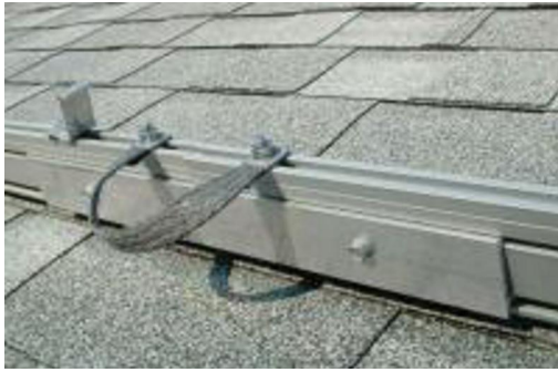
Şekil 4 :Güneş Panellerinde Topraklama
