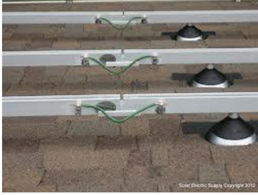
Şekil 3 :Güneş Panellerinde Topraklama
