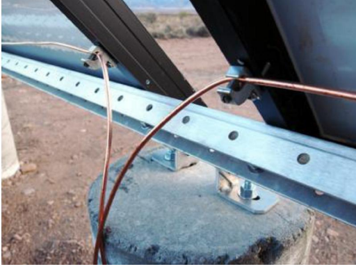
Şekil 2 :Güneş Panellerinde Topraklama
