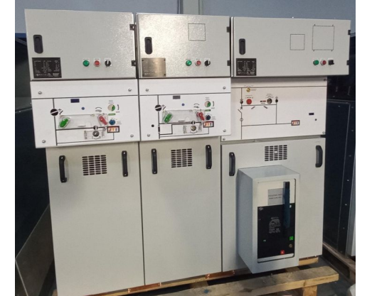
HAVA İZOLELİ METAL MUHAFAZALI HÜCRELER
