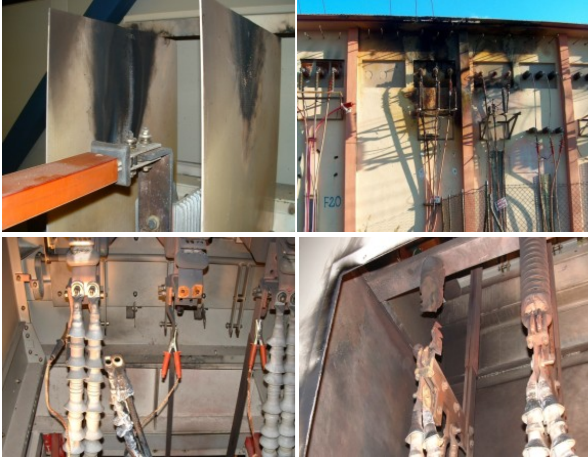
Şekil 3a-b-c-d: Arıza Örnekleri; a)OG kesicinde kapama anında oluşan kısadevre, b)Parafudr arızası, c)Kablo başlığı arızası, d)Mesnet izolatörü arızası
