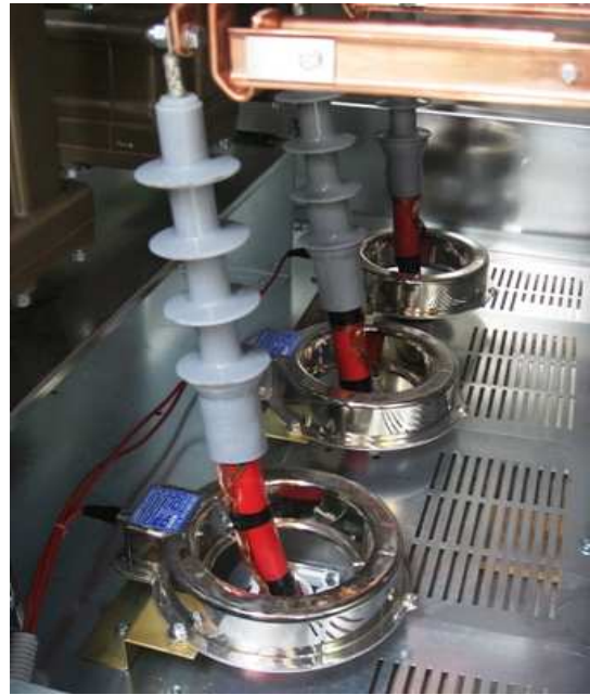
Resim-1 Toroidal tip rogowski bobini akım sensörünün orta gerilim dağıtım sisteminde kullanılması
