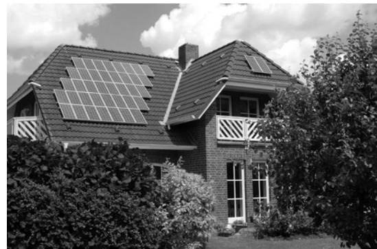
Şekil 12 Çatı Üzerinde Fotovoltaik Panel Uygulaması
