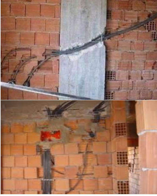
Şekil 5. Kolon ve duvar döşemesi üzerinden hatalı geçen elektrik hatları
