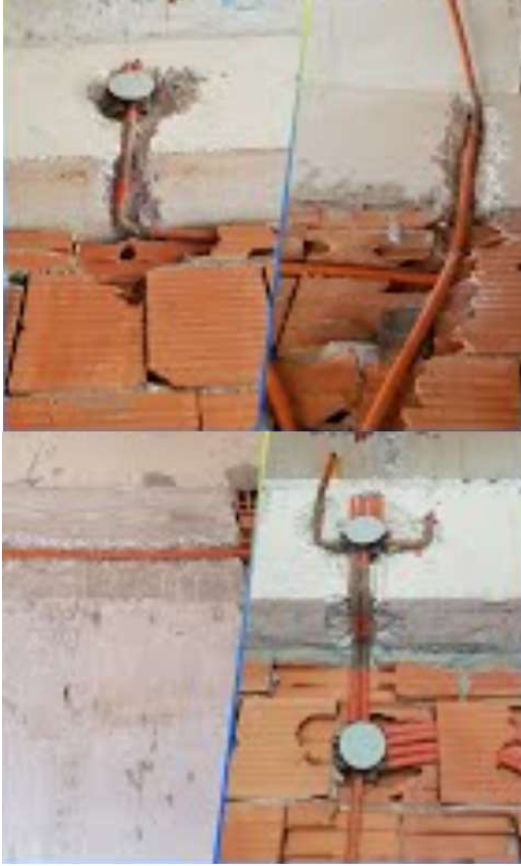
Şekil 6. Kiriş ve duvar döşemesi üzerinden hatalı geçen elektrik hatları
