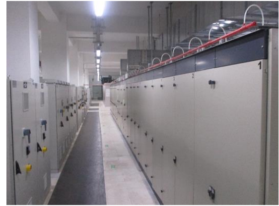
Resim 2. Elektrik panolarında VESDA algılama sistemi uygulaması
