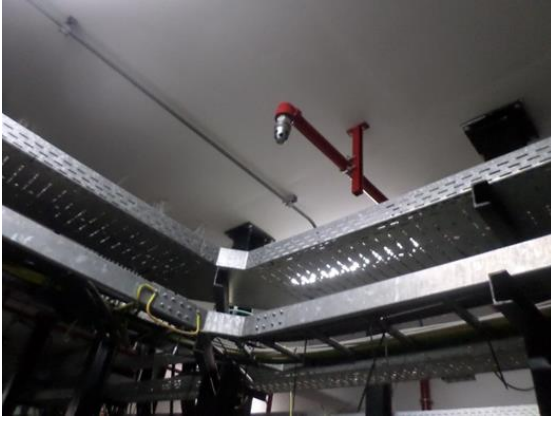
Resim 3. Kablo galerilerinde bulunan detektör
