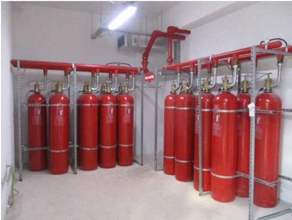
Resim 4. FM200 (HFC227) gaz tüpleri odası
