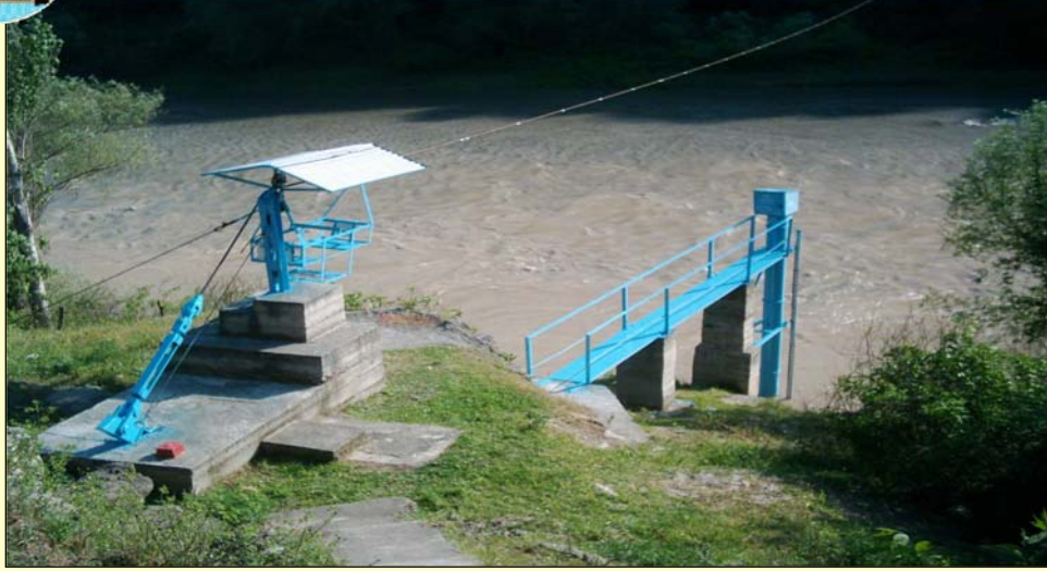
Örnek Resim 1402 nolu Yeşilirmak Nehri Kale AĞI Boru Limnigraf ve Teleferik Tesisi
