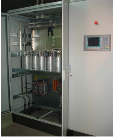
Şekil 8 AGF güç katı ve kontrol panosu
