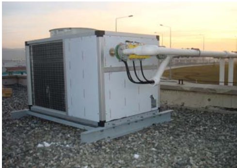
Şekil 9 Çatıya tesis edilen AGF sulu soğutma sistemi
