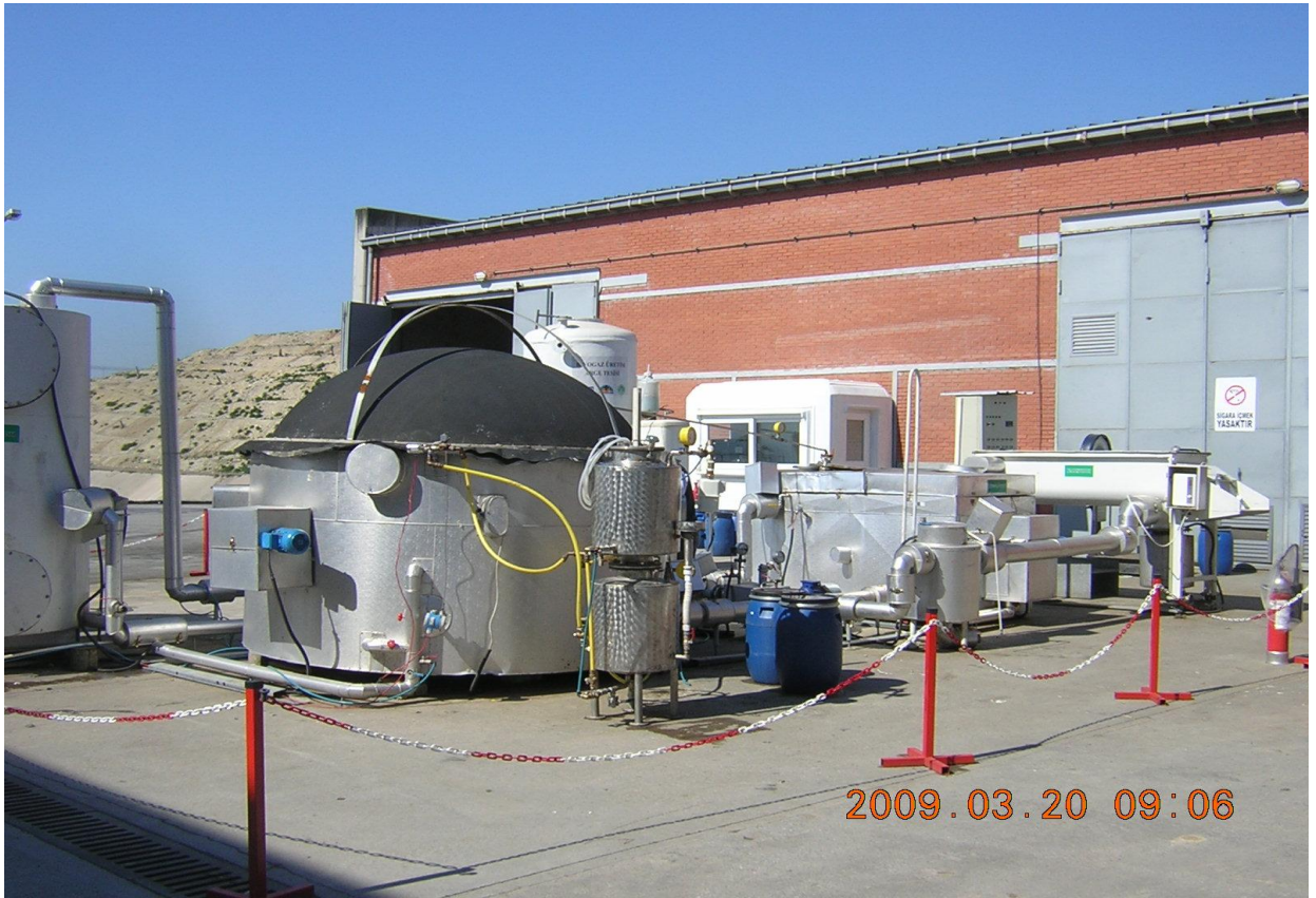
Şekil 2. İki fazlı Ar-Ge amaçlı biyogaz üretim tesisi genel görünüşü
