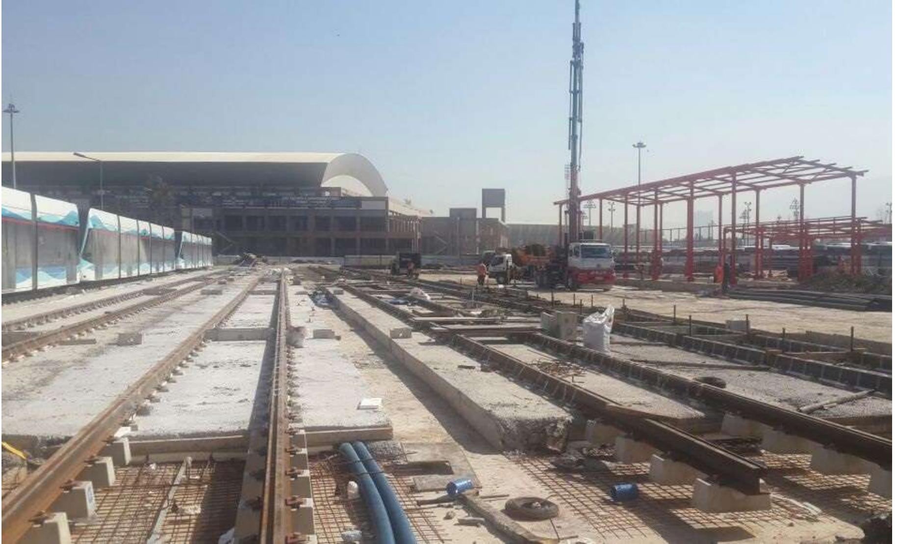
Halkapınar Açık Depolama Alanı, Tramvay Araçları ve Yıkama Ünitesi
