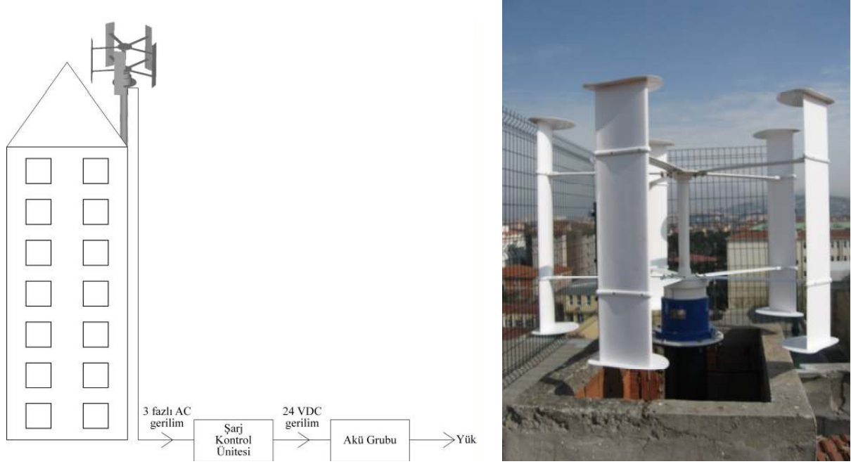
a b Şekil 6.a. Küçük Güçlü Rüzgar Türbini Uygulamasının Prensi Şeması b. Marmara Üniversitesi Göztepe Kampüsündeki Uygulama Görüntüsü
