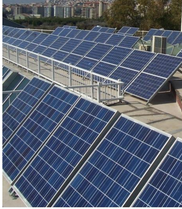
Şekil 4. Fotovoltaik Güç Sistemi
