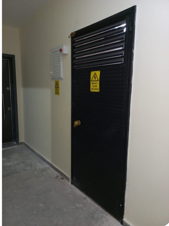
Şekil 11. Enerji Odası Kapısı
