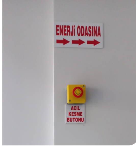
Şekil 13. Enerji Odası ve Acil Kesme Butonu Etiketleme
