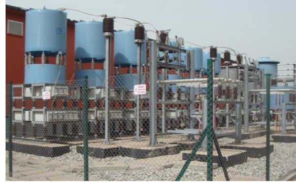
Şekil 3.5: 55 MVAr gücünde harmonik filtrelili kompanzasyon tesisi
