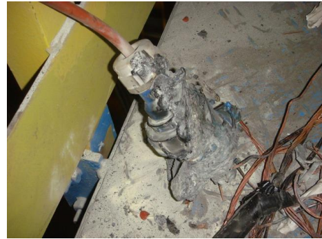
Şekil 1.4: Aşırı akım nedeniyle yanan bir ekipman
