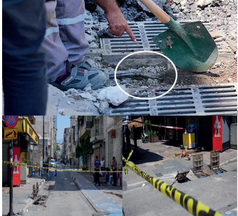
Resim-4 Elektrik çarpılma olayının gerçekleştiği yere ait resimler
