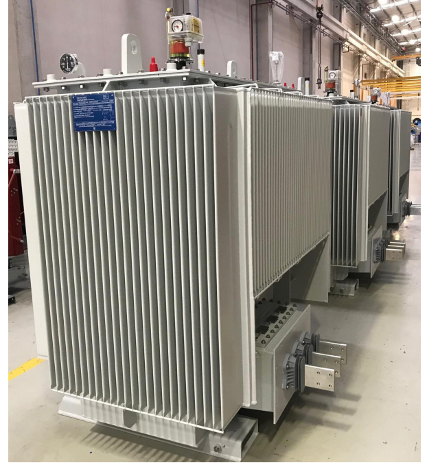
Şekil.4. Kazan Duvarından Bağlantı Yapılan Hermetik Transformatör
