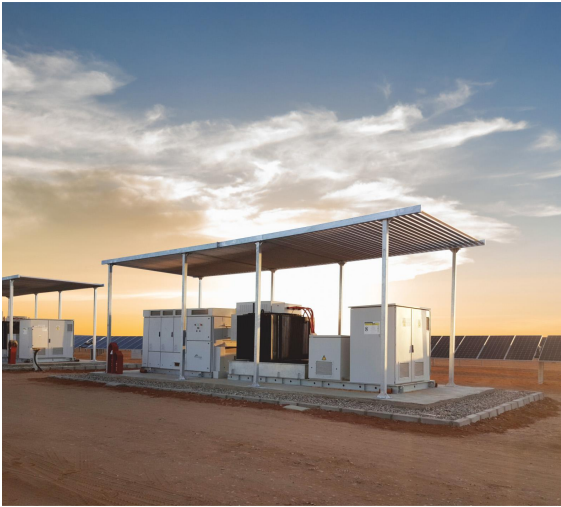
Şekil.5. Güneş Enerjisi Santrallerinde Kızak(Skid) Uygulaması
