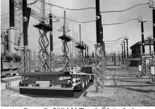
Ototrafo 380 kV Tarafı Ölçümleri
