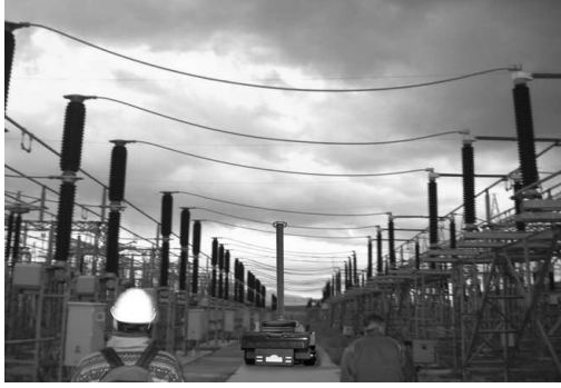
Tek Faz 380 kV RCVT Kullanımı
