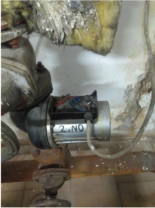
Şekil 6 Açıkta kalan motor terminali
