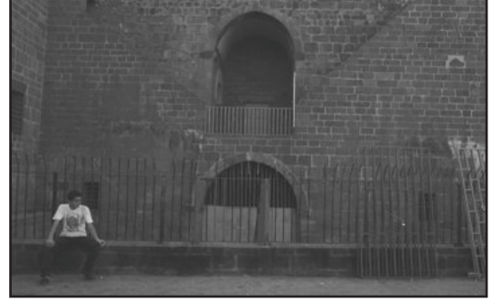
RESİM – 8 Tarihi surların en önemli müze kısmında bazı kesimlerin Tarihi yapısına uzak renklerin kullanılıp boyanması (doğal aydınlatmada) ve diğer hatalı uygulamaların görüntü kirliliği yaratması. Yapay aydınlatma hiç uygulanmamış.
