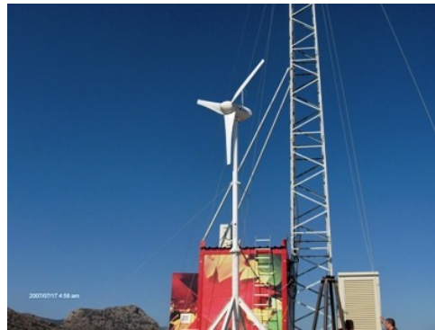
Şekil 2. Tipik bir otonom rüzgâr türbini örneği: Baz istasyonu uygulaması (Datça / İzmir)
