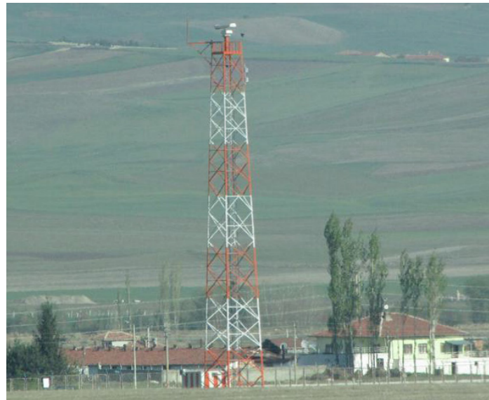
* Şekil-5: SMR Anten ve İstasyonu
