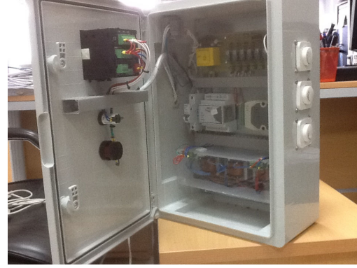
Şekil 6. Transformatör kontrol ünitesi
