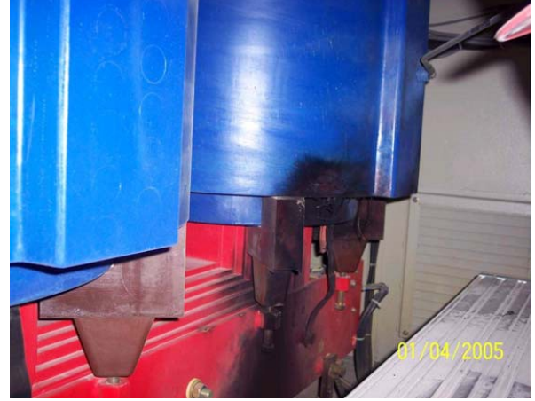
Şekil 1: Hasar görmüş bir transformatör.
