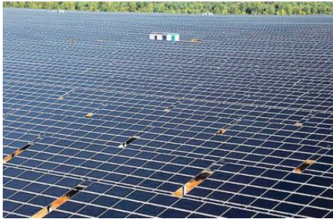
Şekil 7. Şebekeye Bağlı Santral Tipi PV Sistemi
