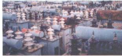
Şekil 1.1. Kaçak elektrik kullanımı sonucu aşırı yüklenmeden bozulan transformatörler.
