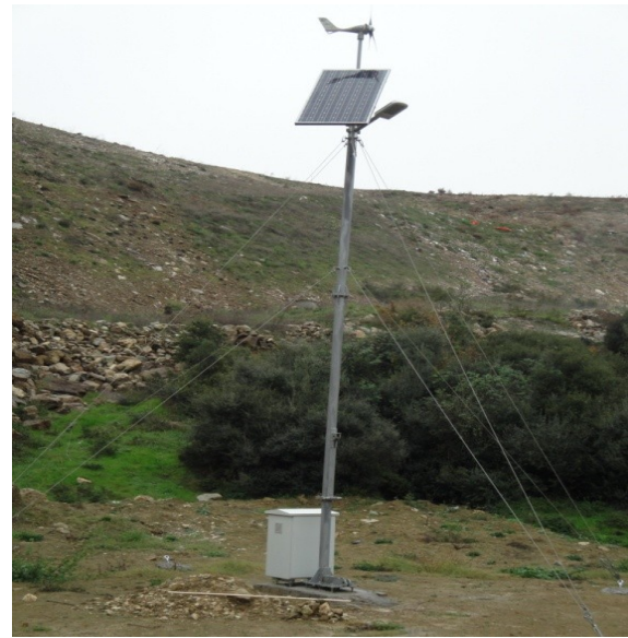
Şekil 5. Fotovoltaik enerji depolama sistemi fotoğrafı.
