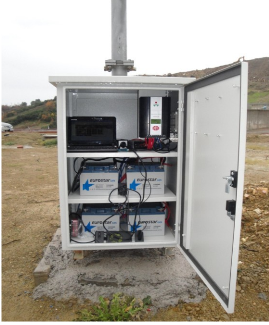
Şekil 6. Fotovoltaik enerji depolama sistemi, şarj kontrol cihazı, akü gurubu ve enerji kayıt sistemi fotoğrafı.
