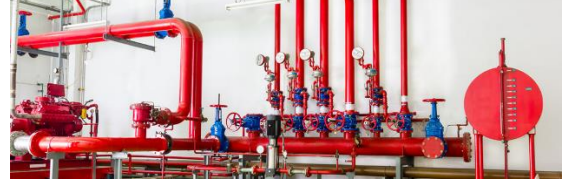
Şekil 1. Yağmurlama sistemi merkezi
