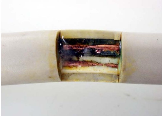
Fotoğraf 4: 100 VAC PVC kılıflı elektrik kablosunda ıslak ark takibi (Fotoğraf: Yasuaki Hagimoto).
