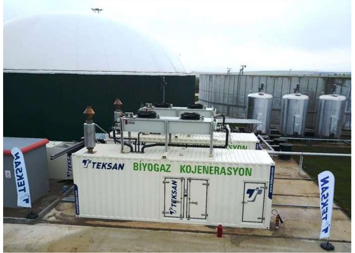
OĞUZELİ BİYOGAZ ENERJİ SANTRALİ 2 x 499 kW
