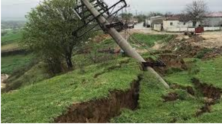
Görsel 4: Toprak Kayması Sebebiyle Devrilen Elektrik Direği
