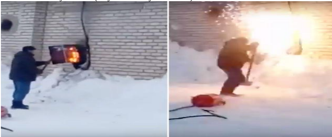
Görsel 6: Rusya'da yangın kar ile söndürülmeye çalışılırken, kardan dolayı içeri giren su nedeni ile kısa devre olan panonun patlaması
