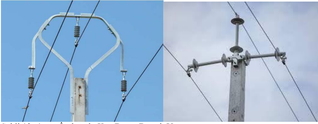
Şekil 13: Asma İzolatörlü Kuş Dostu Destek Yapısı
