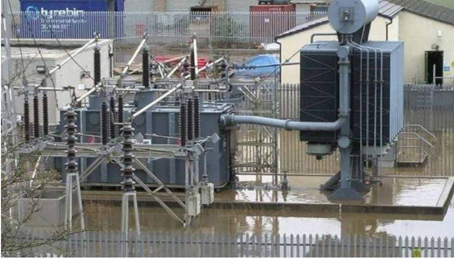
Görsel 3:Yüksek Riskli Bir Trafo Merkezi
