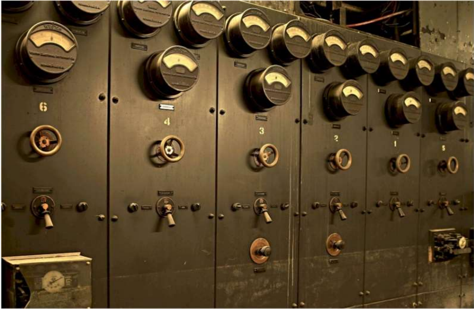
New York Oteli DC elektrik panosu-2
