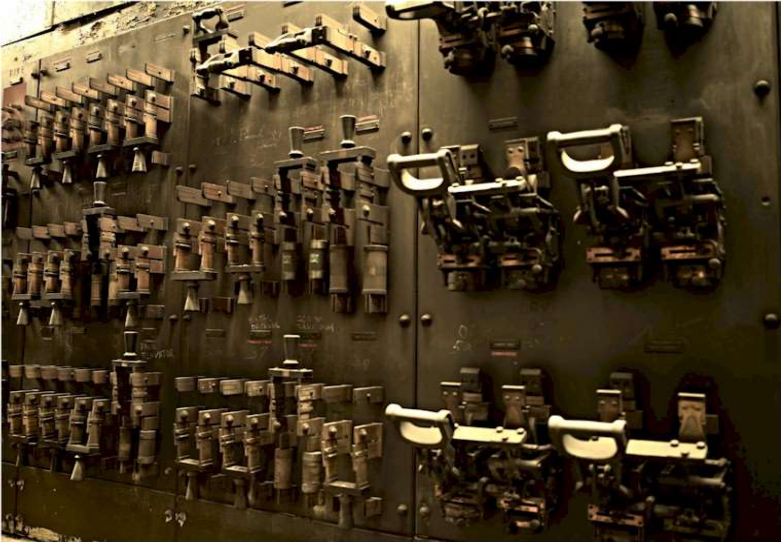
New York Oteli DC elektrik panosu-1
